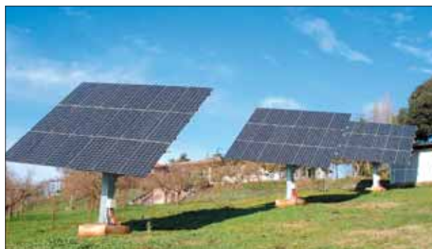
Impianto fotovoltaico semovente realizzato a Paliano (FR).
