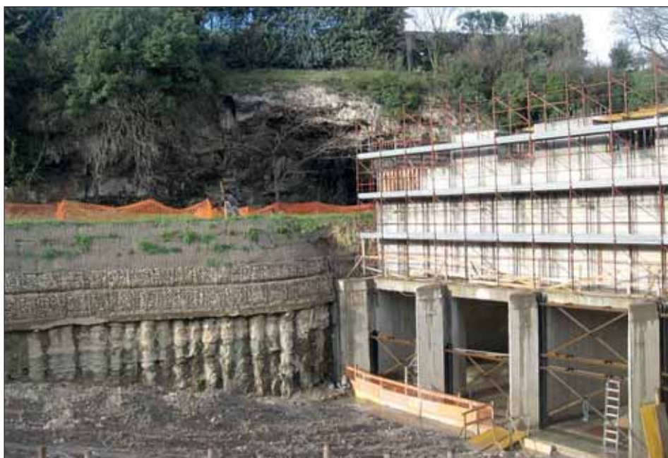
La centrale idroelettrica in corso di costruzione davanti alla Grotta Polesini da parte della stessa società che ha progettato la costruzione di una nuova centrale al Fosso della Prata.
