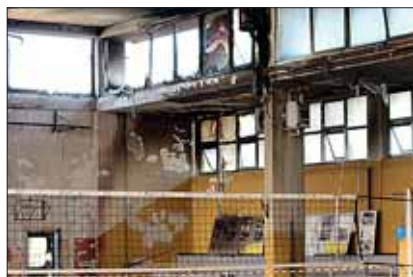
L'interno della palestra dopo l'incendio
