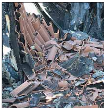
L'interno del chiosco dopo l'incendio
